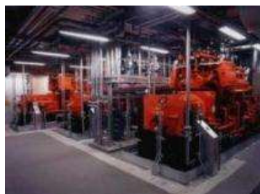
(コージェネレーション・システム)
