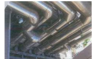
図 川崎病院配管の例 病院施設は、365日24時間稼働しており、通常施設より劣化の進行が速い可能性がある。
